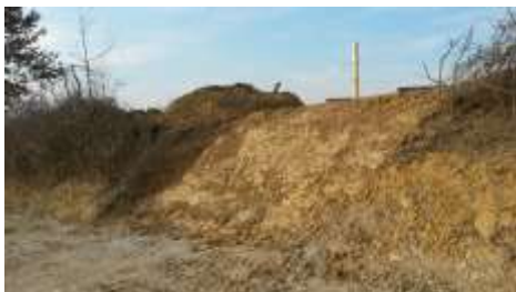
Geschütztes Offenlandbiotop wurde bei Bauarbeiten unzulässiger Weise über mehrere Meter durchbrochen: Nach Meldung schritten Verwaltung und Landratsamt ein. Es wurde für Ersatz gesorgt.
